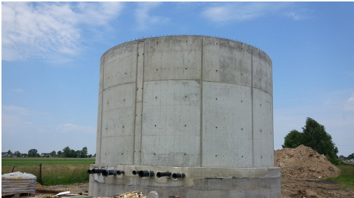
Zbiornik wyrównawczy na wodę uzdatnioną o pojemności 300 m 3 Stacji Uzdatniania Wody w Wielgolesie Duchnowskim.
