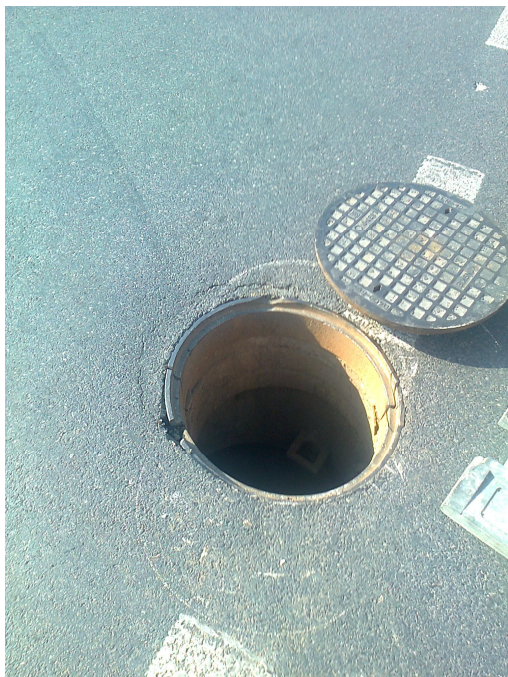
Uszkodzony właz żeliwny
