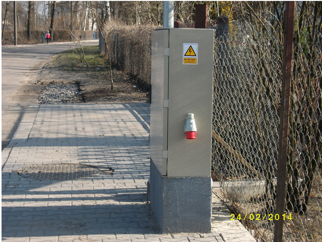
Przepompownia ścieków na ul. Hipolitowskiej, Hipolitów.
