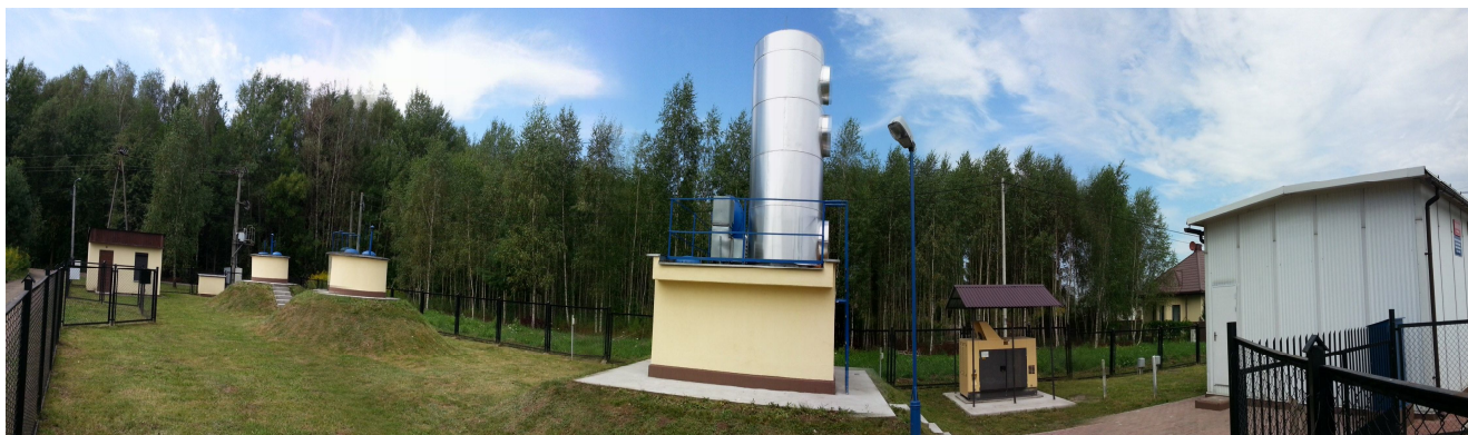
Zmodernizowana Stacja Uzdatniania Wody w Okuniewie
