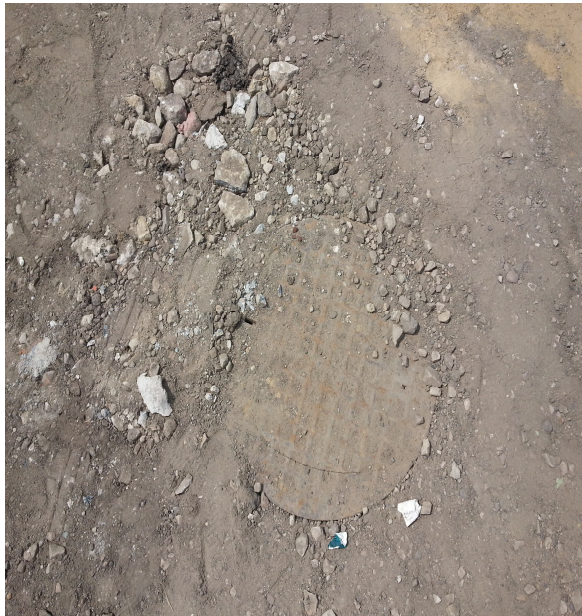
Uszkodzony właz żeliwny
